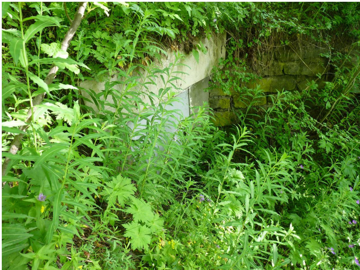
Photo 4 : Aperçu de la source du Villard (chambre de réunion)
