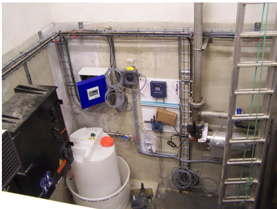
Photo n° 3 : Aperçu d'un traitement par électro-chloration
