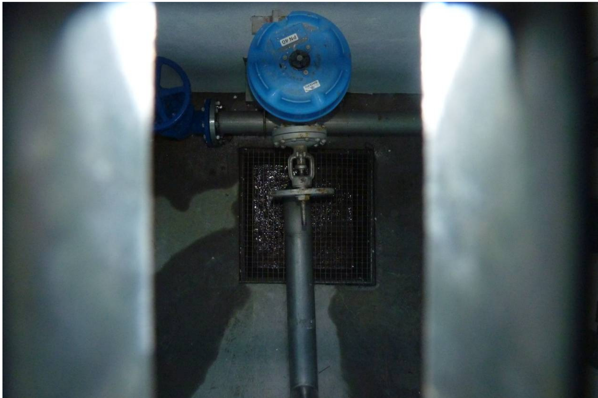
Photo 6 : Aperçu de la sortie du trop plein du réservoir des Charbonnières
