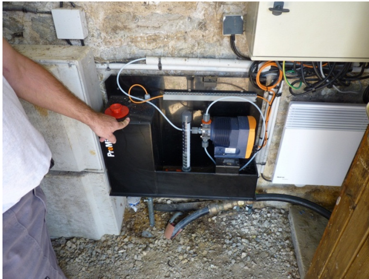
Photo n° 2 : Aperçu d'un traitement de javellisation
